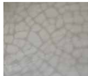
Popraskaná stěrka – přelití vody.
