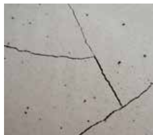
Popraskaná stěrka – špatná penetrace.
